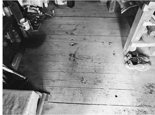
床板に転用された掩体の屋根材（坂祝町）
